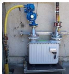
FCD installé sur détendeur
